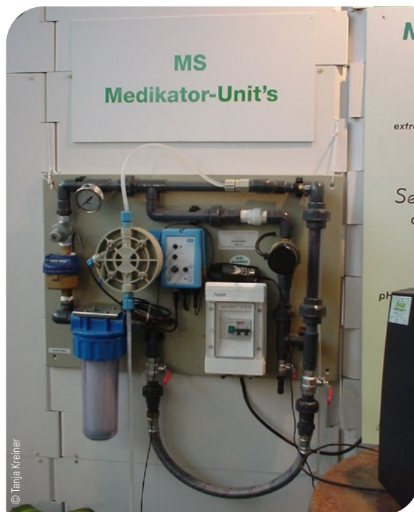
Abb. 15: Für die Verabreichung von Impfstoffen über das Tränkwassersystem müssen im Bestand die technischen Voraussetzungen gegeben sein.
